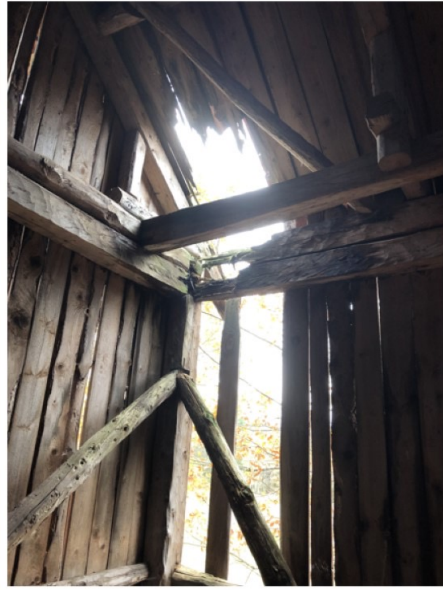
Ladans sydvästra hörn kraftigt rötskadat
